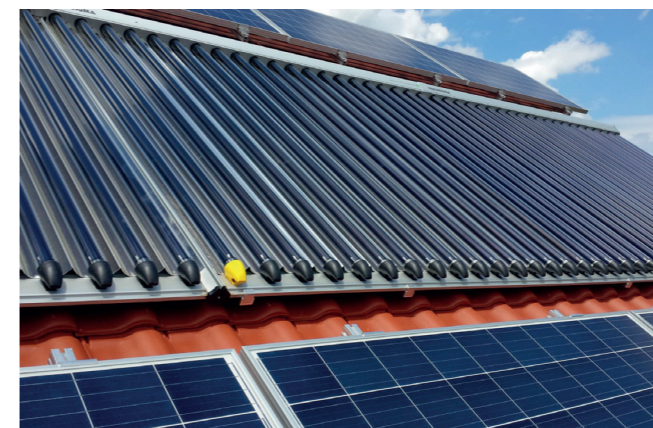
beispielhafte Installation von Solarthermie und Photovoltaik, B2K und dni, 2021
